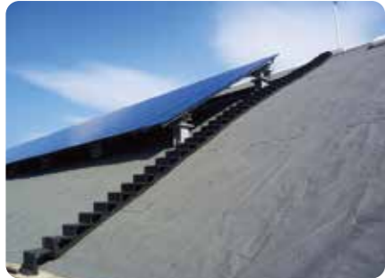
太陽光パネル下(東九州道 日向)
